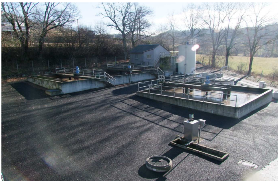
Station d'épuration de Laguiole (traitement par boues activées capacité de traitement = 4833 équivalents habitant)
